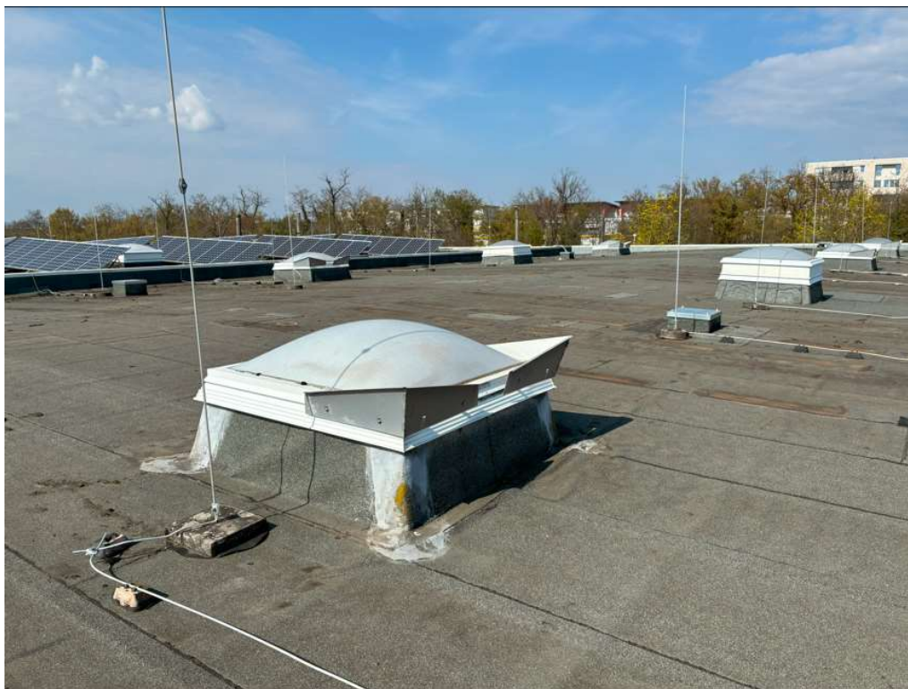
Bild: Lichtkuppel u. Schacht
